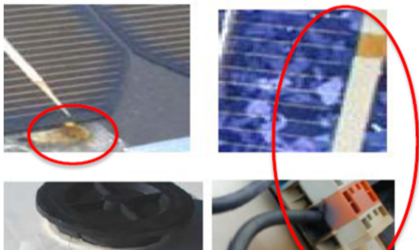
组件内部烧坏
